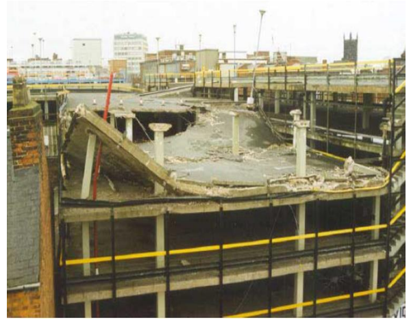
Рисунок 1.2 – Обрушение конструкций парковки в Вольферхантоне
